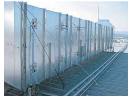
消臭剤噴霧ダクト
