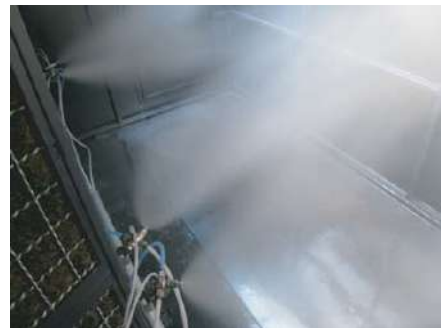
ダクト内噴霧の様子
