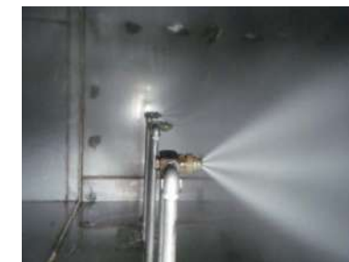
ダクト内の噴霧の様子
