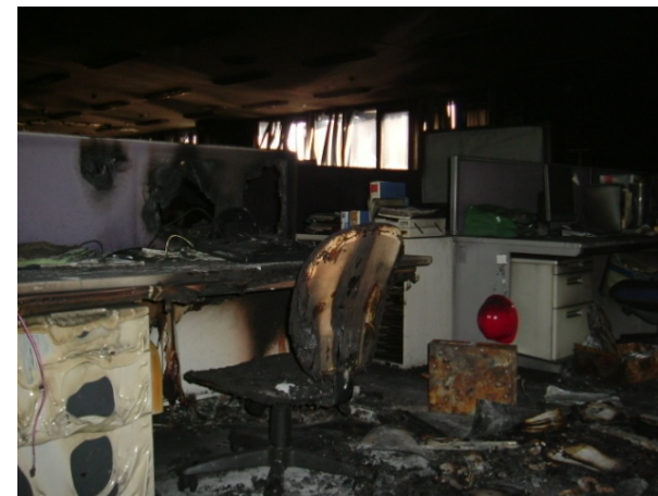
▲オフィスの火災現場
