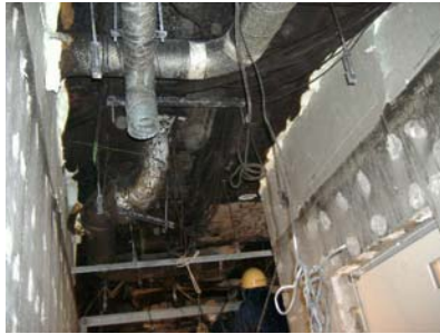
漏電により火災が発生
