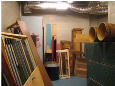
カビが発生している地下室の倉庫
