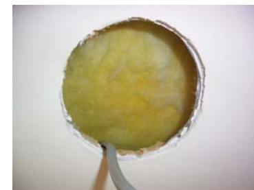
臭気の発生源はグラスウール
