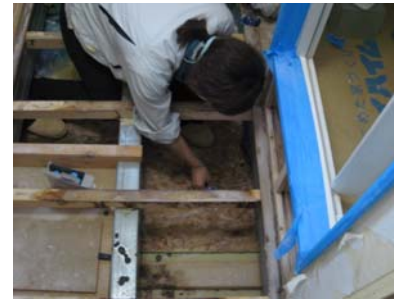
カビの発生箇所をチェック
