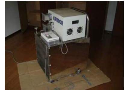
室内に大型オゾン脱臭機を設置
