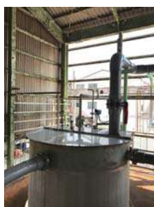
対策後処理槽②
